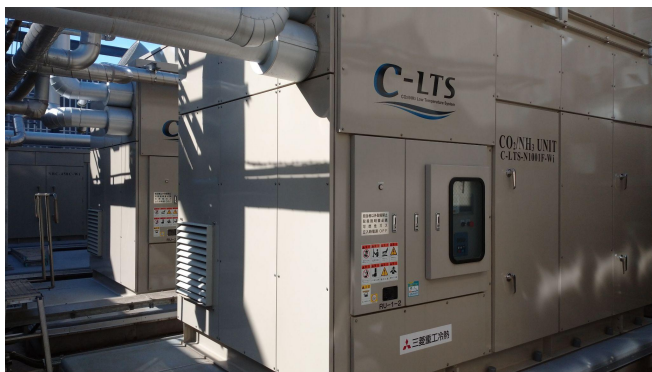
※屋上に設置された最新大型冷凍機(一部)
