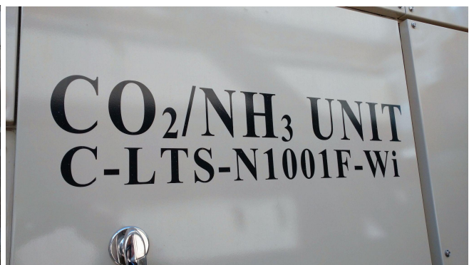
※自然界に存在する二酸化炭素(CO 2 )とアンモニア(NH 3 )のハイブリッドシステムによる高効率冷却システムを採用
